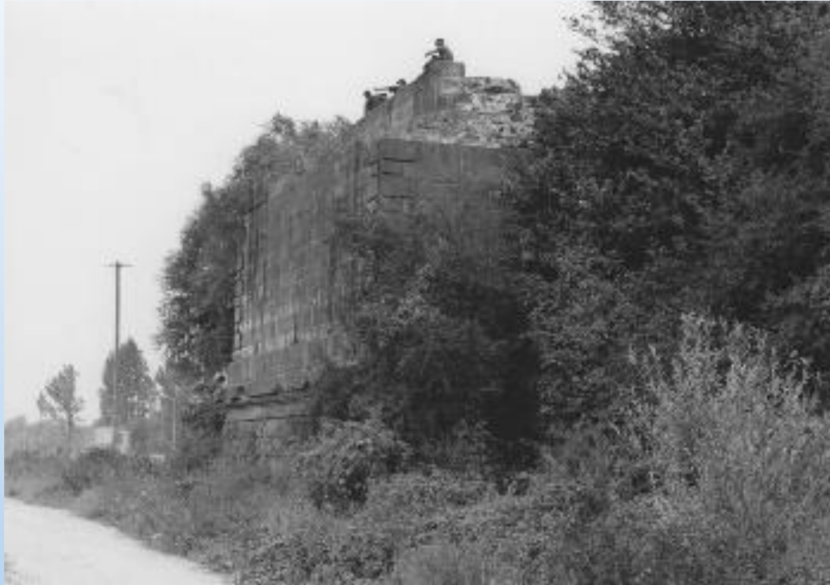
Der linksseitige gesprengte Landstützpfiler
